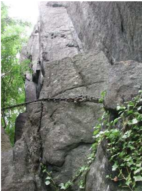
Figur 14: Avløst "berg pillar" med tvilsomme stabilitetsforhold, angitt med gul pil på fotografiene i Figur 13. Rød pil i øverste fotografi viser åpen sprekk som avløser en bergblokk på antatt flere tonn
