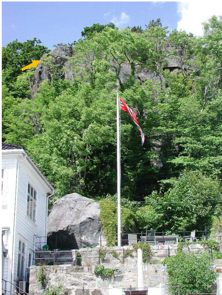
Figur 13: Bergparti med tvilsomme stabilitetsforhold, bak ytre ende av Havnegata. Øvre fotografi viser detalj i øvre, venstre del av kollen i nedre fotografi. Gul pil angir avløst "berg pillar" (se fotografier i Figur 14).
