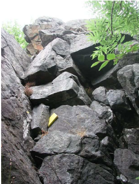
Figur 9: Avløste blokker med behov for tilleggssikring. Lokalitet N58 43.304 E9 13.918
