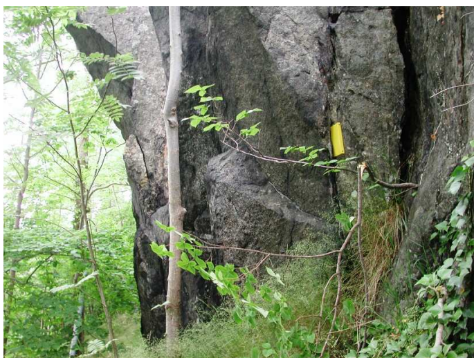
Figur 15: Bergparti med tvilsomme stabilitetsforhold, 10-15m øst for "berg pillar" vist i Figur 14
