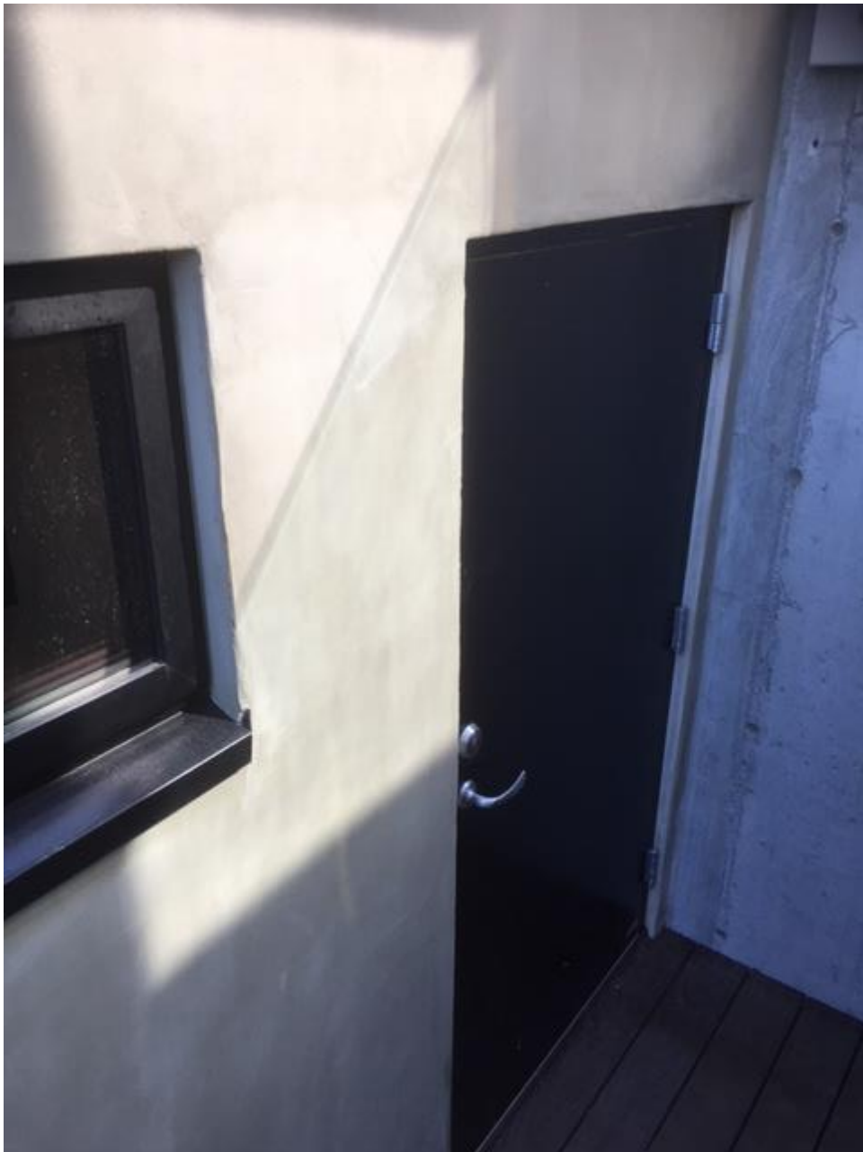
Kjellerdør under hytta – uklart om rommet innenfor har lavere takhøyde enn 1,9 m som godkjent.
