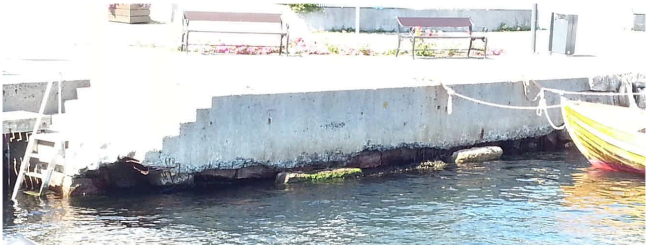
Zoom og kontrastjustert av bilde ovenfor. Viser rød granittmaur fra gamle dager under betongstøp. Betongstøp har blitt defekt av sjøvann og is, men mesteparten av gammel steinmur fremdeles står.
