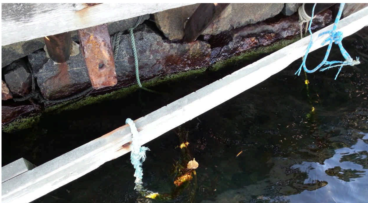
Bryggehollas natursteinmur med defekter i trebryggas dekke, bjelker og jernkonstruksjon. Men stålstøttene med støp har klart mange tiår med sjø og is.
