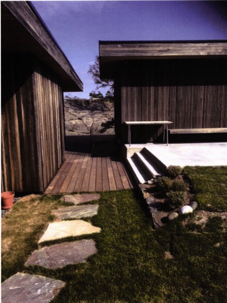
Overgang mellom hytte og anneks mangler sammenhengende tak.
