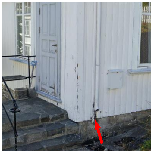
Figur 29: Begynnende skade i kledning.
