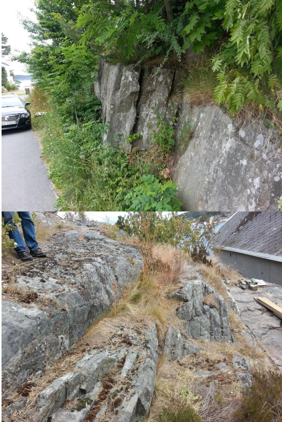
Bilde 6-7. Blotninger i terrenget ovenfor tomt. Hovedoppsprekning langs foliasjonen er synlig.
