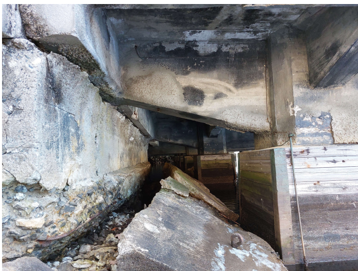
Figur 13: Bølgeerosjon som har medført skader på betongfundament under bygget.
