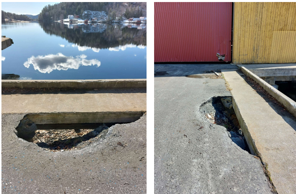
Figur 12: Utvasket fyllmasser ved kai, ved byggets vestre side.
