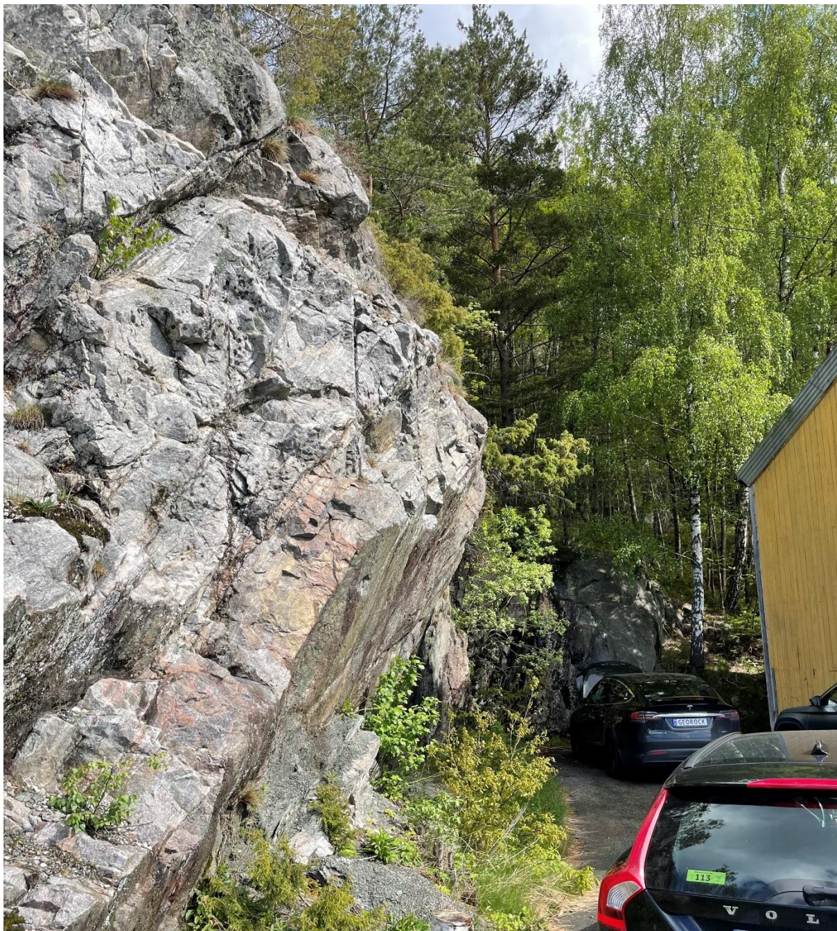
Figur 6 – Bilde fra vestsiden av den eksisterende hallen som viser lagdeling med glideflater og overheng.
