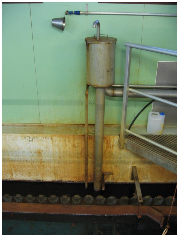
Figur 2 Betong og mamutpumpe ettersedimentering
