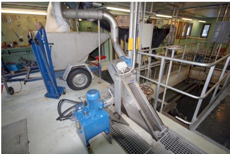
Figur 11 Innløpsrist, ristgodspresse, og slamtilhenger
