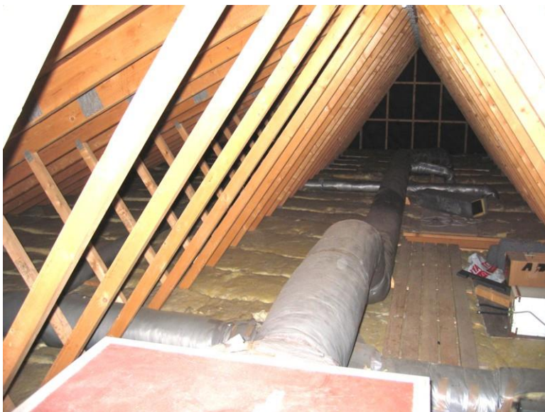
Figur 9 Ventilasjonsskanaler på loftet
