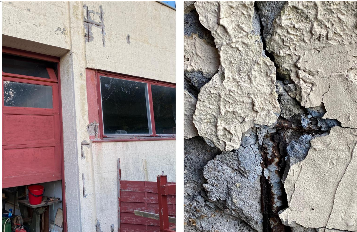
Figur 20 Bildene viser avskallinger av fraksjoner på eksisterende bygningsmasse
