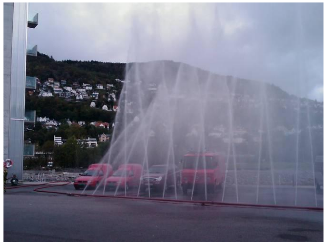
Figur 10 Brannslange med vannveggfunksjon
