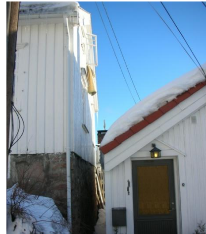
Figur 6 Svekkelser i gavlvegg
