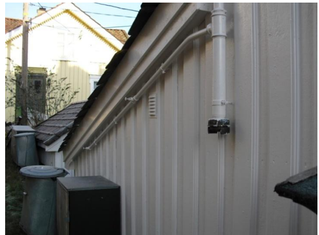
Figur 15 Fasadesprinkler etablert i samråd med byggesak ifm søknadspliktig tiltak
